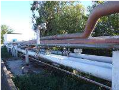
canalisations SPBA et VERMILION
