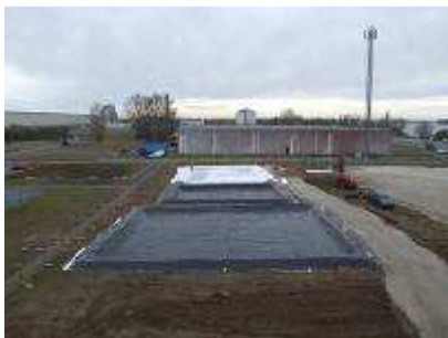
site EDF FIRE vu de la centrale
