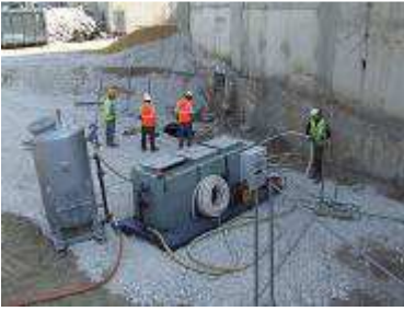
pompage des eaux résiduelles avec passage dans une unité de traitement
