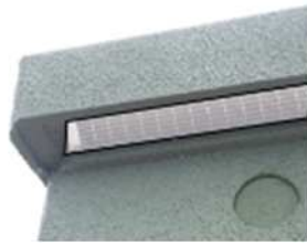
transformateur BT-HTA « stockage GE »
