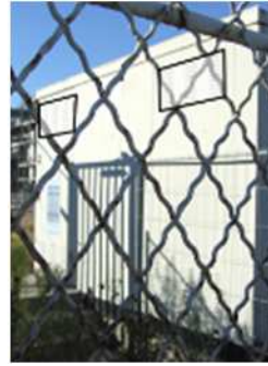
transformateur BT-HTA « cellule de vie »
